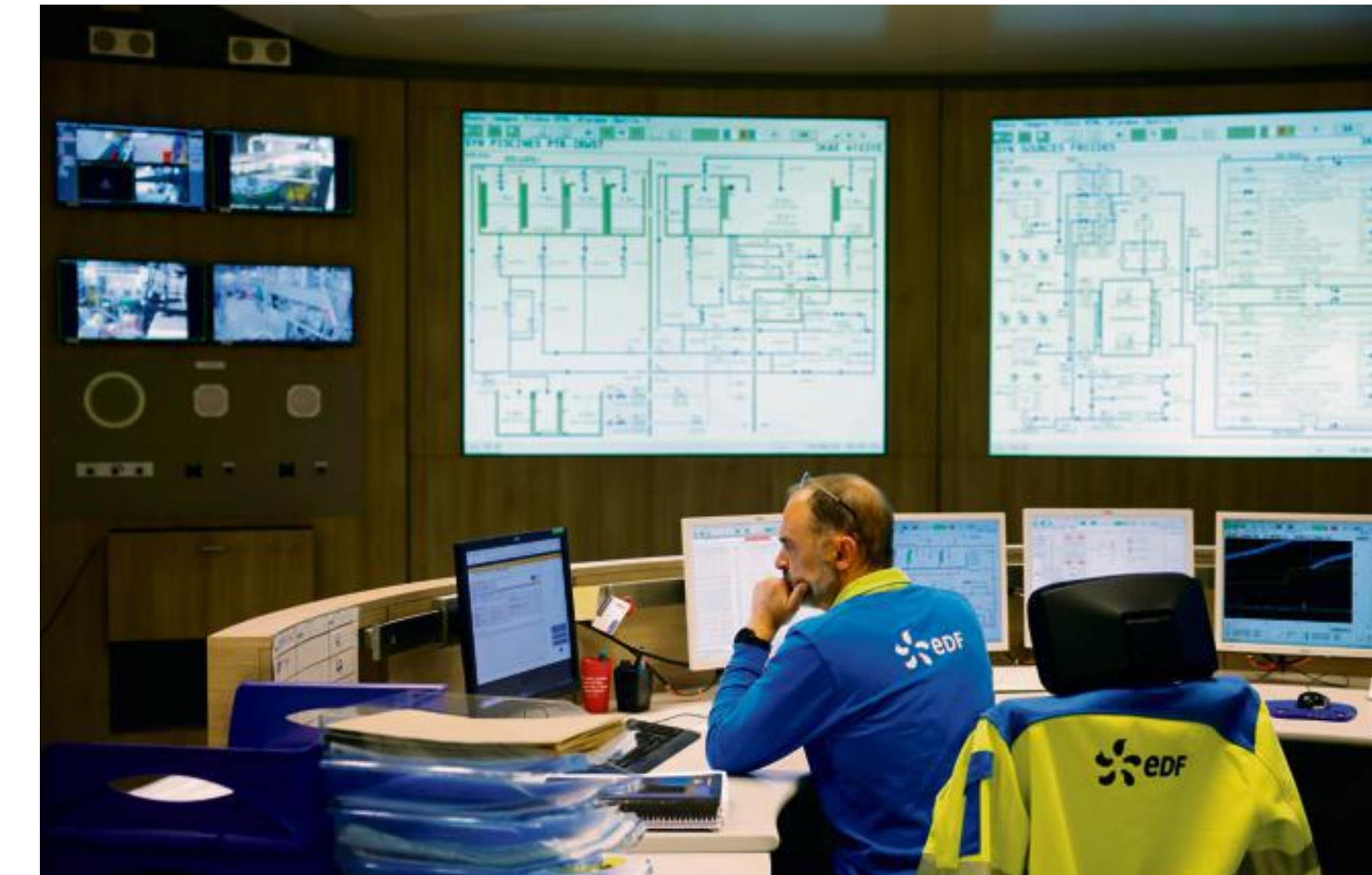
Dans la salle de contrôle, sur le chantier du réacteur nucléaire EPR, à Flamanville (Manche), le 14 juin 2022. SARAH MEYSSONNIER/REUTERS
