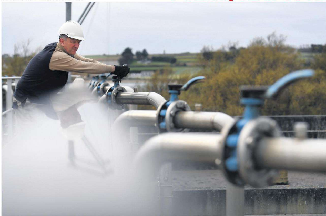
Station de traitement des eaux usées de Carantec (Finistère).
